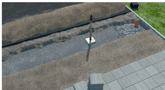
Kaevake renni jaoks süvend, tihendage, renni alla valage ca 5 cm kõrge ja 15 cm lai betoonalus.
